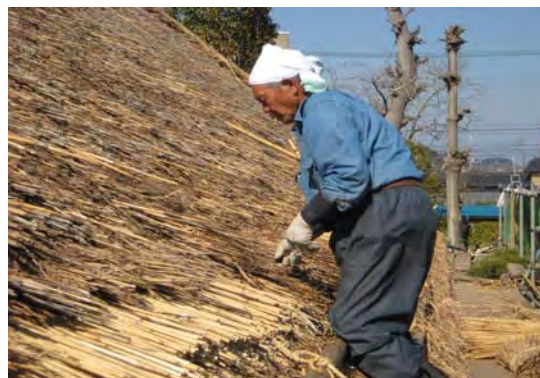
山武市・伊藤左千夫の生家 屋根改修作業中の佐藤講師 2008.5.14 茅葺屋根の準備葺の加工作業
